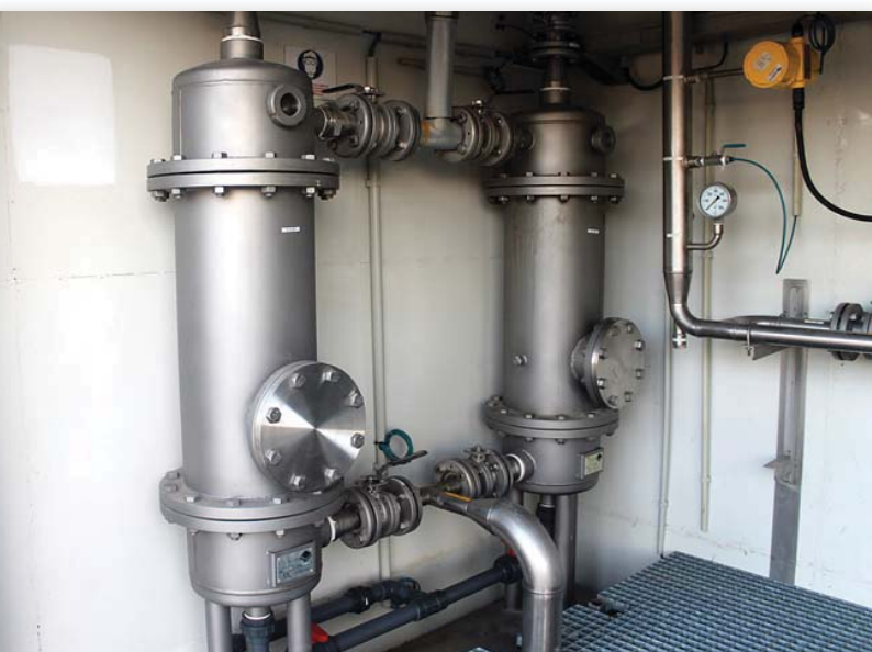
Distintas imágenes del sistema de purificación de la planta de demostración del proyecto agroBiomet. Este es el área de limpieza y purificación del biogás.
