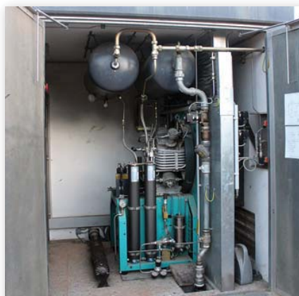
El área de suministro, con el sistema de compresión y la estación de suministro.
